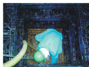
作業員が貯留槽内に入って清掃が可能です。※必ず作業要領書に従い、換気などを行ってください。
